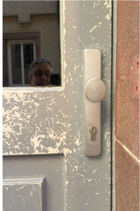
Detail Bauzustand Haustür
