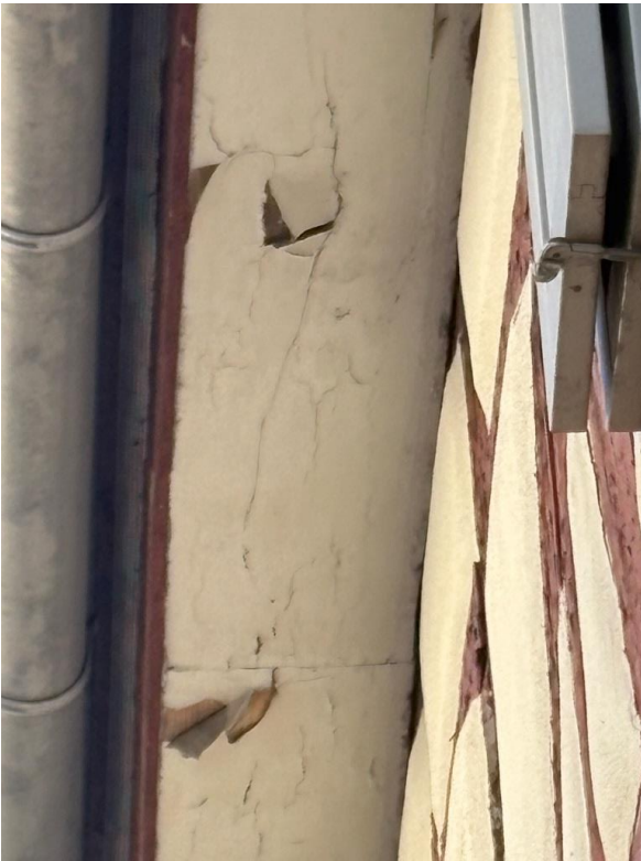
(15) Dito andere Schadensstelle
