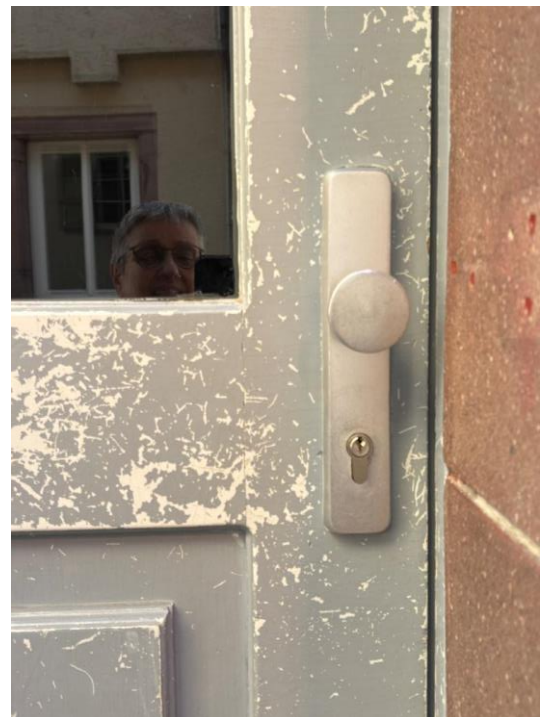
Detail Bauzustand Haustür
